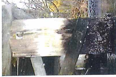
Abb. 70: Oberer Bereich eines Pfahls unter dem Zugangssteg bei ca. 20 cm Niedrigwasser
