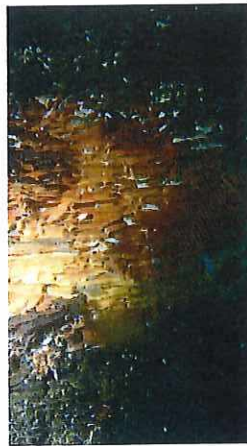
Abb. 72: Eichenholzpfahl mit deutlich sichtbaren Spuren der Bohrmuschel
