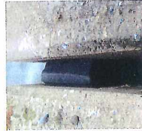
Abb. 36: Größere Fugenbreite mit gelockertem Gummilager zwischen den Elementen Nr. 4 und Nr. 5
