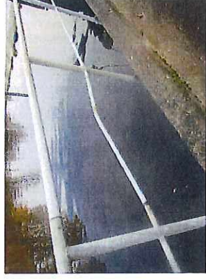
Abb. 85: Geländerschaden auf der Ostseite
