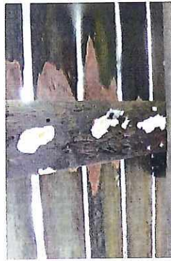
Abb. 11: Untersicht der Belagsbohlen und eines Längsbohlen mit Pilzbefall
