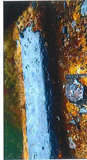
Abb. 89: Stahloberfläche eines gereinigten Schienenprofils unter Wasser
