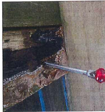
Abb. 12: Durch Pilzbefall zerstörte Holzstruktur bis in ca. 5 cm Tiefe
