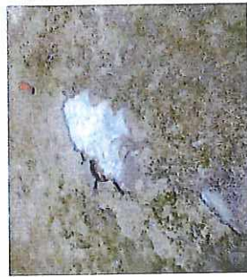
Abb. 27: Beschichtungsschaden am Schleppblech zum Schwimmsteg
