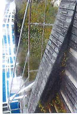
Abb. 21: Geländerkonstruktion mit Oberflächenkorrosion
