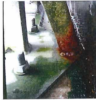
Abb. 49: Beginnende Korrosion an einer Verstrebung eines Dalbenschlosses
