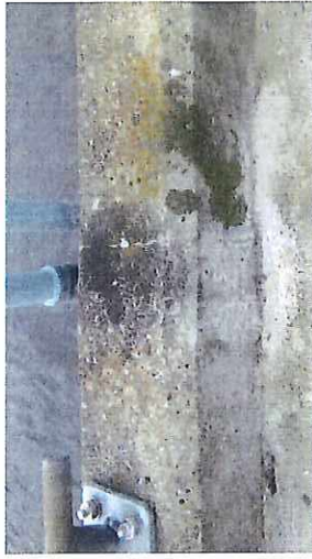
Abb. 84: Westliche Betonaufkantung mit Riss und Sinterungsprodukten
