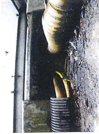
Abb. 54: Leitungen und Schutzrohre am Beginn des Schwimmstegelements Nr. 1
