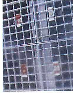
Abb. 25: Korrodierte Verbindungsmittel der Gitterroste
