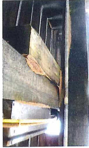
Abb. 13: Pilzbefall an Traghölzern in der Steguntersicht
