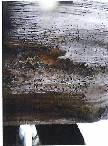
Abb. 15: Gründungspfahl mit Spuren des Holzwurmbefalls
