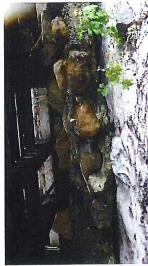
Abb. 19: Hohl liegender Beton vor dem nördlichen Auflager
