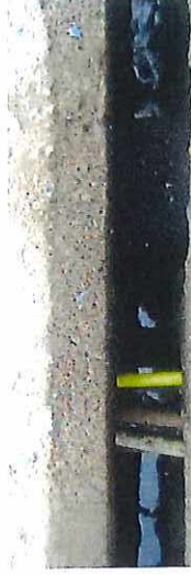
Abb. 55: Leitungen und Schutzrohr im Bereich einer Koppelfuge
