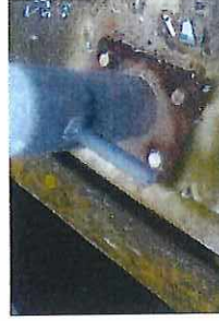
Abb. 38: Korrodierte Fußplatte eines Pollers
