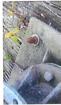
Abb. 73: Korrodierte Verschraubung der Kranfußplatte
