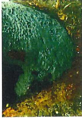
Abb. 90: Durch Korrosionsmulden geschädigte Stahloberfläche des gereinigten Mastpfahls unter Wasser
