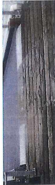
Abb. 23: Schlepblech am Übergang Holzsteg / Zugangsbrücke
