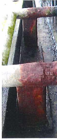
Abb. 43: Korrodierte, obere Verankerungskonstruktion einer Steigleiter
