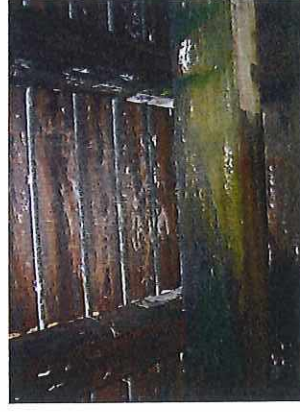
Abb. 64: Untersicht der Plattform mit Schimmel- oder Pilzbefall
