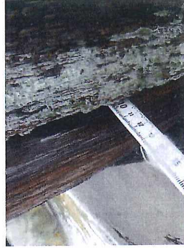
Abb. 14: Gründungspfahl mit tiefen Längsrisse
