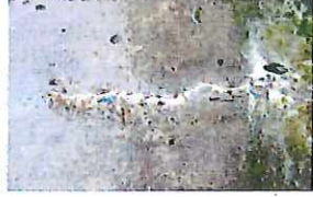
Abb. 33: Lotrechter, zugesinterter Riss
