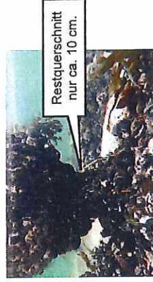
Abb. 17: Südwestlicher Pfahlkopf mit starkem Bohrmuschelbefall
