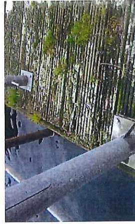
Abb. 62: Verrottete und brüchige Bohlen an der Nordseite
