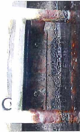
Abb. 40: Stark korrodierte Steigleiter in der Wasserwechselzone
