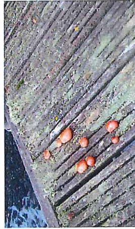
Abb. 61: Pilzbewuchs auf dem Bohlenbelag
