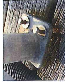
Abb. 22: Gelöste Verschraubung eines Geländerpfostenfußes
